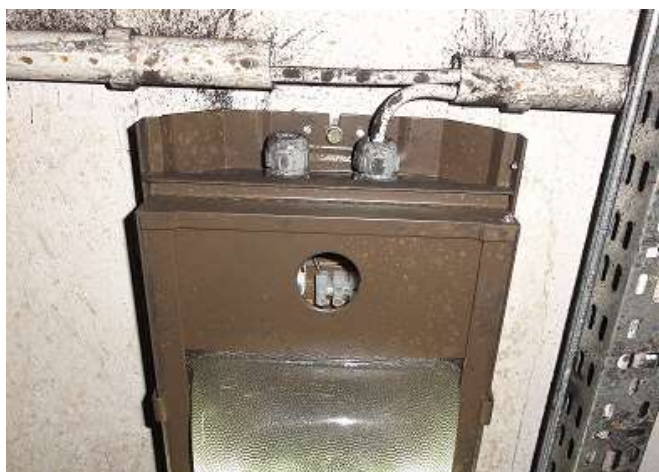
FOT. 2 Brak zaślepienia niewykorzystanego wpustu kablowego w sprawie oświetleniowej
