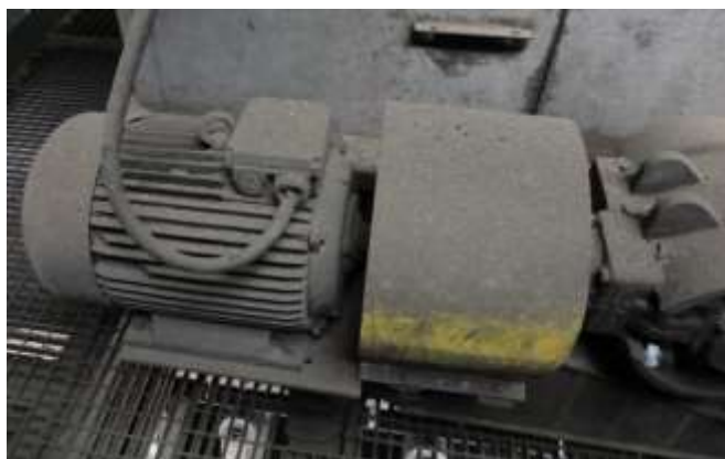
FOT. 1 Niewłaściwe wprowadzenie przewodów do silnika
